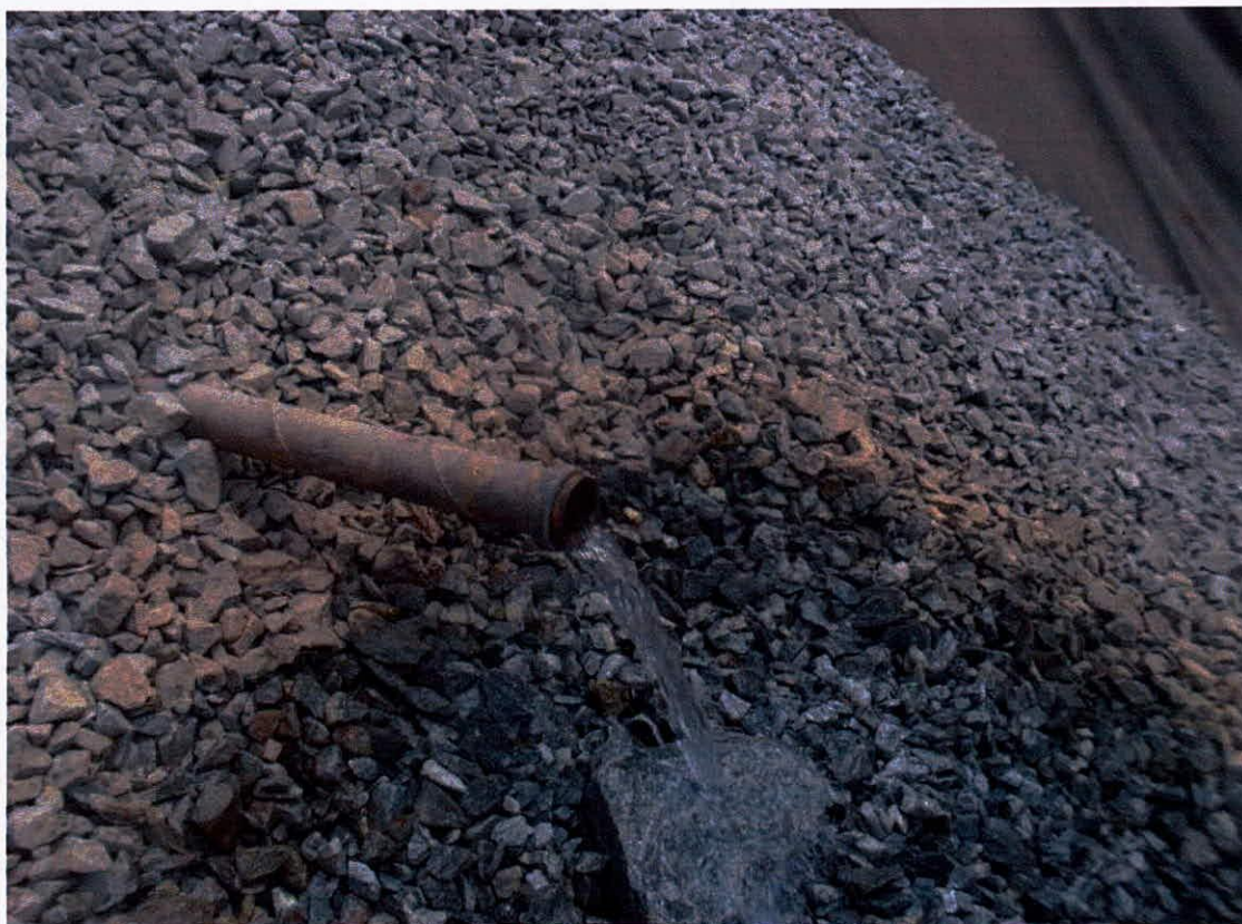
Figura 17: Vista de dreno – DHP instalado no talude a jusante do dique de sela da BCP, ombreira direita, com a finalidade de diminuir as poropressões no maciço do barramento causado por surgências de água.
