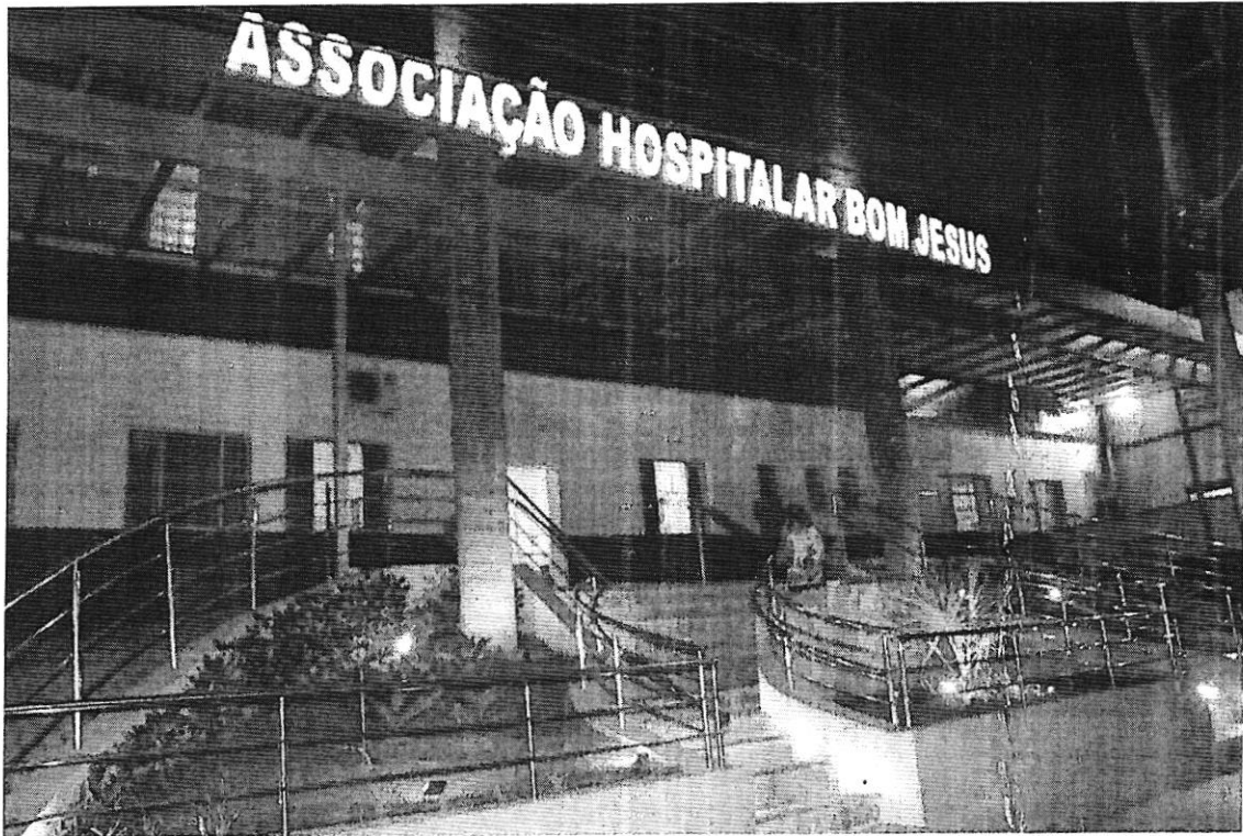
Reforma do calçamento da rampa de entrada e revitalização da fachada e cobertura.
